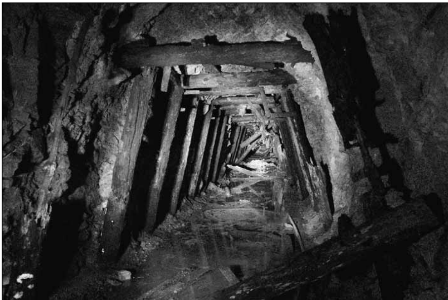
Značilna trapezasta podporna tesarba v rudnikih 19. stoletja, tu primer rudnika svinčeve rude pri Veliki Pirešici nad Žalcem v Savinjski dolini, na nadmorski višini 489 m. Obratoval naj bi do 1886. Foto: G. Schmidt, stanje 2011; objekt Šta-Velika Pirešica Pb-Spodnji Kotnik-(Barbara).
