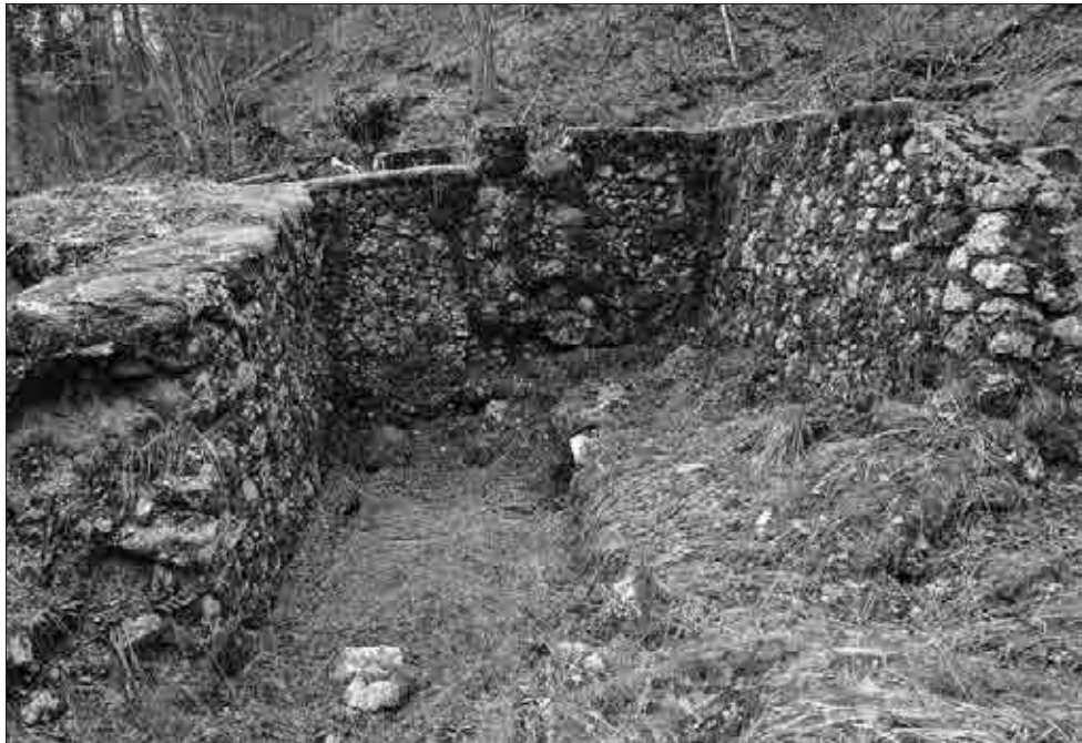
Pogled v prostor B proti vzhodu spomladi leta 2016. V vzhodni steni je vidno, da južni zid prostora D ni bil zgrajen hkrati s to steno, saj na stiku nista gradbeno spojena (foto: V. Pflaum).
