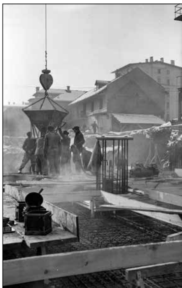
Delavci Gradisa med gradnjo stanovanjskega bloka leta 1953 (MNZS, fototeka, 460/2, foto Božo Štajer)
